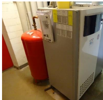
Wolf Brennwärmtherme Bj 2012
