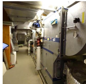
Raumlufttechnische Anlage mit 8.000 m 3 /h
