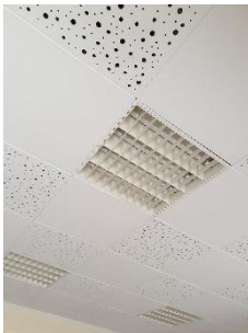
Abbildung 13 Beleuchtung mit LED Röhren im Aufenthaltsraum
